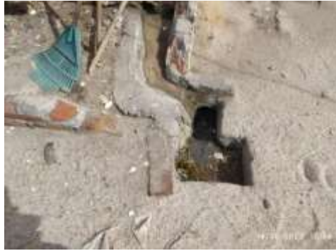
Gambar 3. Kondisi saluran pembuangan air limbah yang tertutup
