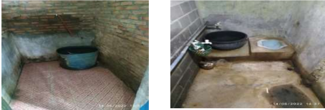
Gambar 1. Kondisi kamar mandi warga di pantai gudang garam
